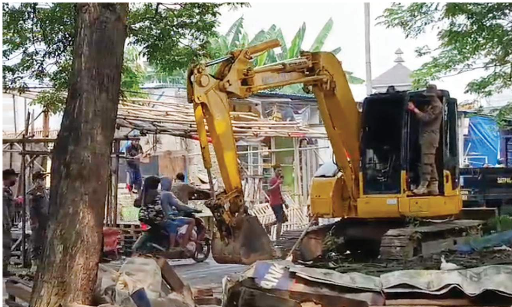
PENERTIBAN: Alat berat dan para petugas Satpol PP Kabupaten Tangerang mulai melakukan penertiban 261 bangunan liar yang berdiri di Sepadan Jalan Raya Puri Jaya, Desa Sukamantri Kecamatan Pasar Kemis, Rabu (6/5).
