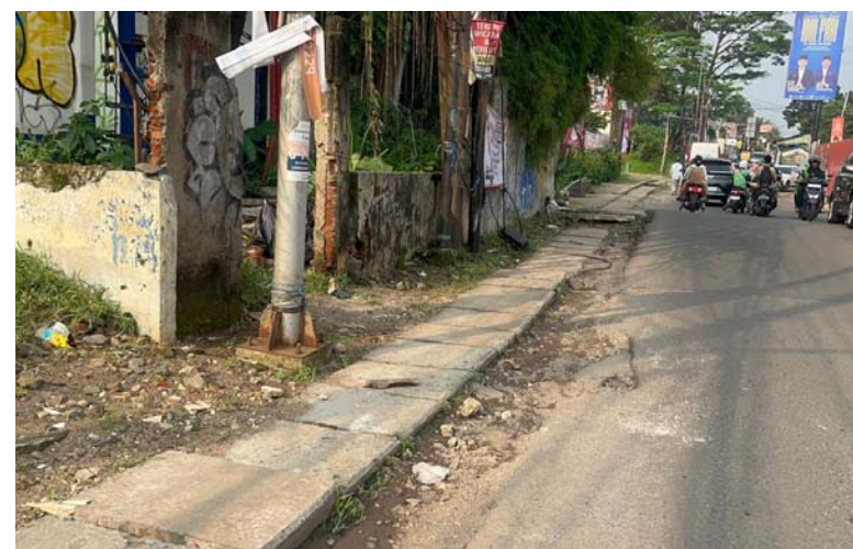
DRAINASE: Drainase di Jalan Aria Putra, kawasan Tanah Tinggi dikeluhkan masyarakat Tangerang Selatan.
